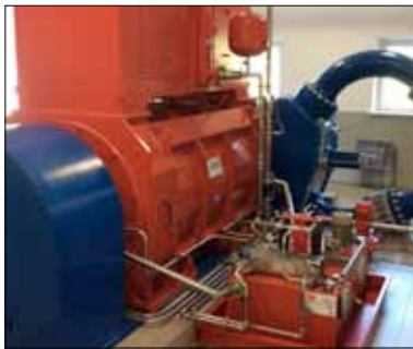
Neue Kraftwerksanlage KW Traualpsee mit 2-düsiger Pelton Turbine des EW Schattwald. Foto: EW Schattwald
